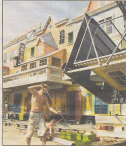
Die Fassade nimmt allmählich Gestalt an, aber bei 40 Grad Temperatur kommen die Männer beim Aufstellen ganz schön in's Schwitzen
